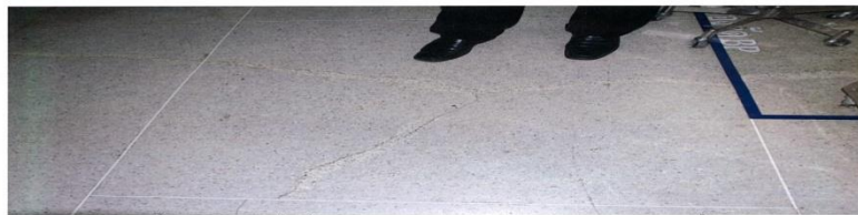
รอยร้าวในแผ่นพื้น คสล. ในชั้นที่ 1 ถึง 3 บริเวณทำงานพยาบาล และทุกชั้นบริเวณโถงลิฟท์
