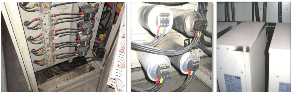
รูปที่ ๒.๗ แสดงคาปาซิเตอร์แบงค์ติดตั้งอยู่ภายในตู้
