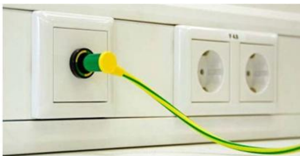
รูปที่ ๔.๔ แสดงสายเสียบสายดิน Grounding jacks
