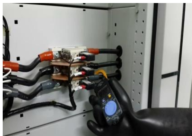
รูปที่ ๒.๘ แสดงการตรวจสอบค่าต่างๆคาปาซิเตอร์แบบติดตั้งอยู่ภายในตู้
