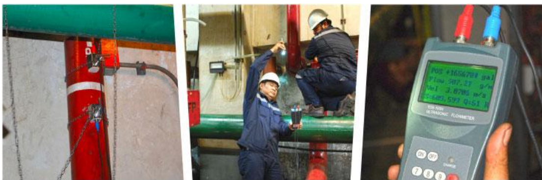
รูปที่ ๗.๑๓ แสดง การติดตั้งจุดตรวจวัดการไหลด้วยเครื่อง Ultrasonic Flowmeter เชื่อมต่อเครื่อง Ultrasonic Flowmeter กับจัดรับ-ส่งสัญญาณเครื่อง Ultrasonic Flowmeter ประมวลผลการทดสอบ
