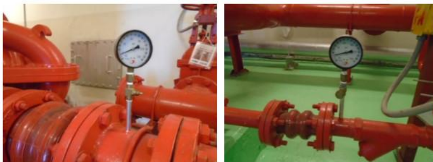
รูปที่ ๗.๑๐ แสดง Pre Pressure Gauge บริเวณด้านดูดและด้านจ่าย
