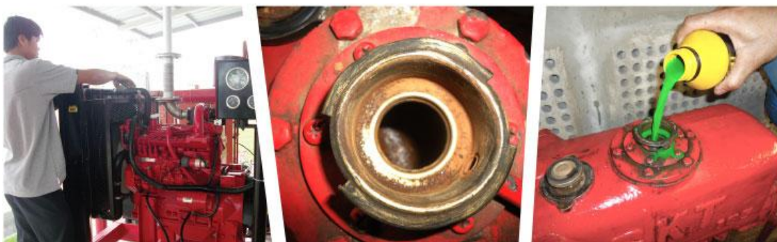
รูปที่ ๗.๔ แสดง ตรวจสอบสภาพและทดสอบประสิทธิภาพการทำงานของ Jockey Pump
