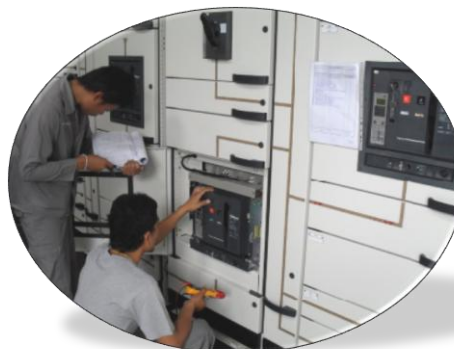
รูปที่ ๒.๑๑ แสดงการตรวจสอบตู้ควบคุมไฟฟ้าหลัก
