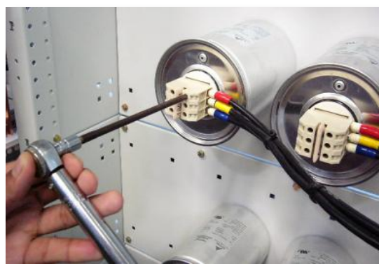
รูปที่ ๒.๕ แสดงการตรวจสอบค่าต่างๆ คาปาซิเตอร์แรงค์ติดตั้งอยู่ภายในตู้
