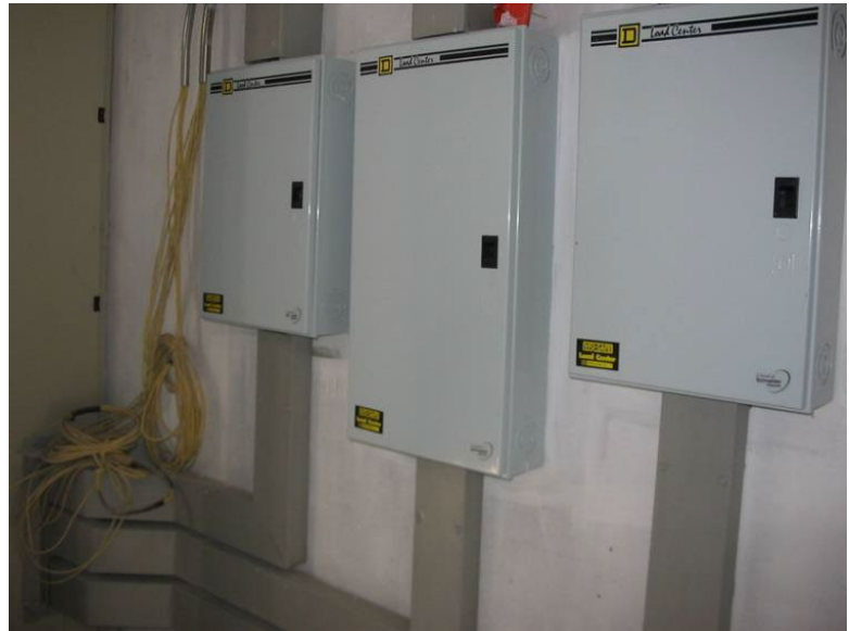
ตู้สวิตช์ตัดตอน (LOAD CENTER)
