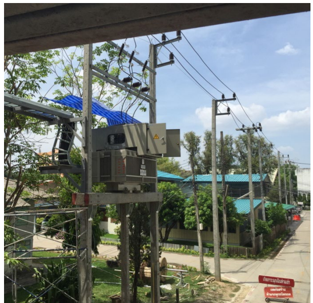
ภาพแสดงตัวอย่างหม้อแปลงที่ติดตั้งบนที่สูง
