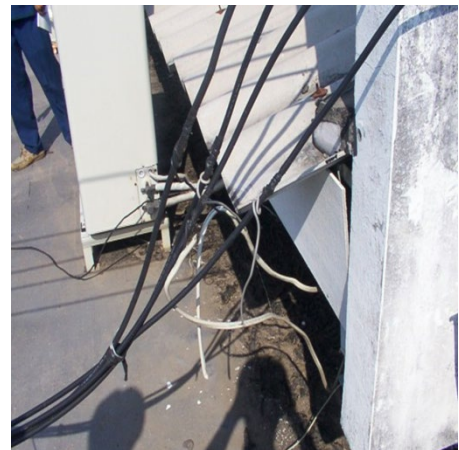
สายไฟไม่เป็นระเบียบเรียบร้อย และไม่ปลอดภัย
