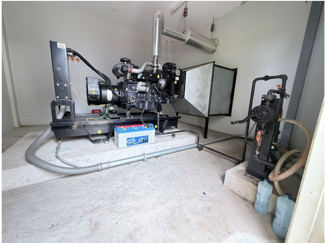
ภาพตัวอย่างแสดงห้องเครื่องกำเนิดไฟฟ้าสำรอง
