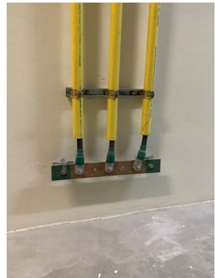
จุดต่อลงดินที่แผงเมนประธานหลักประจำอาคาร(ตู้ MDB)
